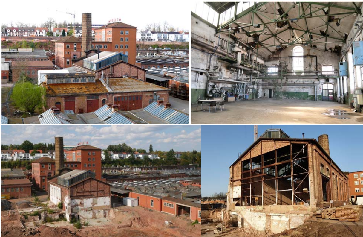
Abbildung 5: Neues Kesselhaus mit Anbauten (oben links), Blick in die Halle (oben rechts), im September 2017, Kesselhaus ohne Anbauten im September 2020 (links) und in der Umbauphase im März 2021 (rechts), Quelle: EnStadt:Pfaff / Fraunhofer ISE sowie EnStadt:Pfaff / PEG (rechts unten)
