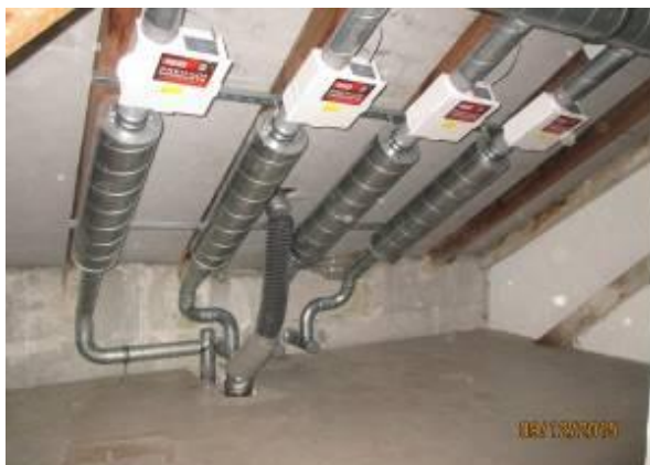
c) Abluftseitige Ventilatoren und Schalldämpfer im Dachboden
