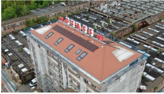
Abbildung 3: Dachintegrierte rote PV-Anlagen
