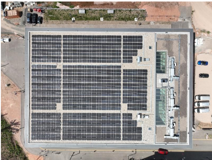
Abbildung 12: PV-Anlage MVZ-Parkhaus, ca. 280 kWp
