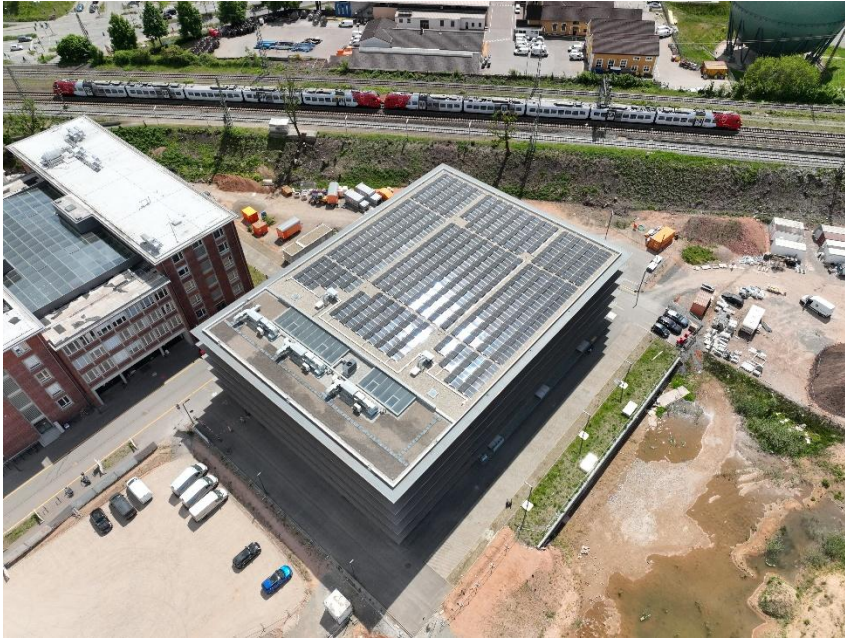
Abbildung 15: PV-Anlage MVZ Parkhaus
